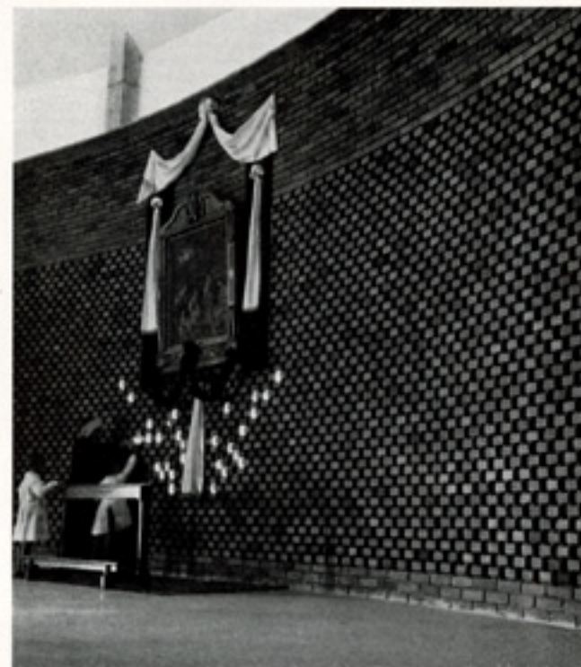
La parete in mattoni pieni in gambetta sotto il matroneo. - The solid brick wall pattern under the matroneum.
